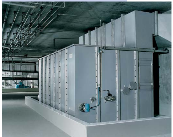
Strahlwaschanlage zur Abscheidung von Farbnebeln aus einer Lackierstraße für Verkehrsflugzeuge, Werkstoff: Edelstahl 1.4571.
