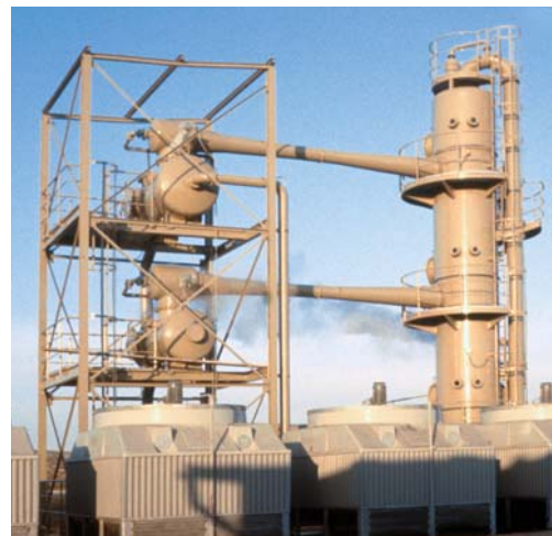
Рис. 9. 3-ступенчатая парожеткторная холодильная установка портального типа, охлаждает 194 м 3 /час воды от 28 до 15 °С. Холодопроизводительность: 2 900 кВт.
