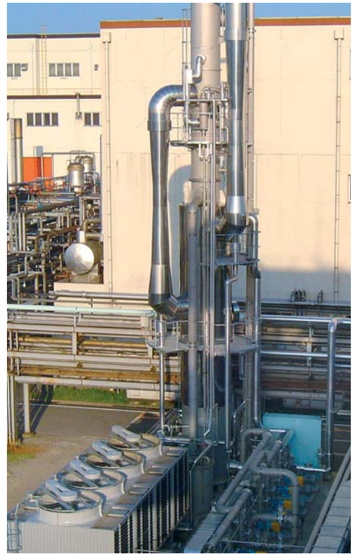
Рис. 7. 2-ступенчатая пароэжекторная холодильная установка башенного типа, охлаждает 200 м 3 /час воды от 10 до 5 °С. Холодопроизводительность: 1163 кВт.
