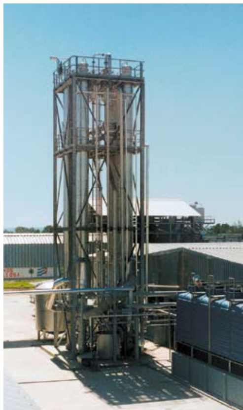
4-stufige Fallstrom-Eindampfanlage für Orangensaft; Verdampfleistung: 12.000 kg/h
