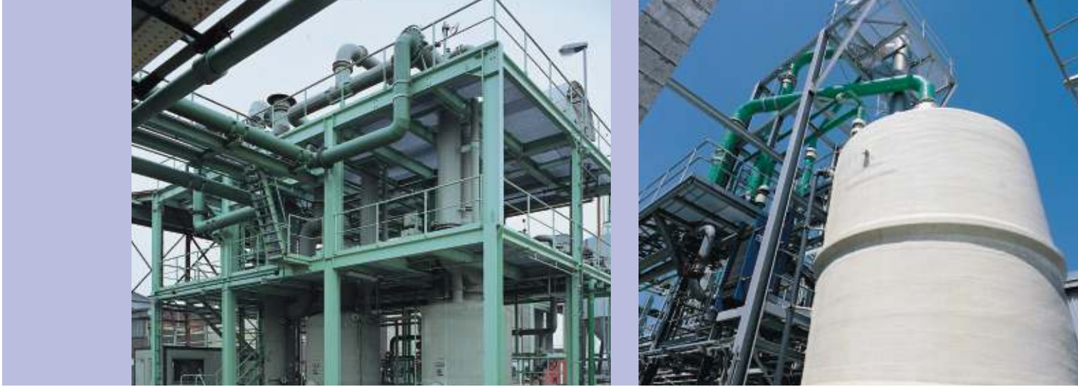
Izquierda: planta de absorción de gases con alto contenido en cloro procedentes de una electrolisis cloro-alcálica para la producción de cloro
