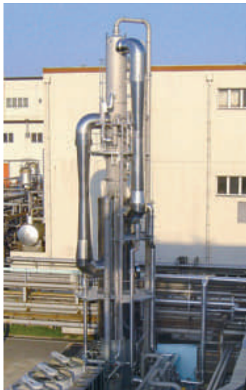
图7：塔式设计的2级蒸汽喷射制冷装置，可将200m 3 /hr水从10℃冷却至5℃。冷却能力：1163 kW
