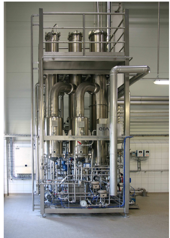
Entalkoholisierungsanlage nach dem Fallstrom-Prinzip
