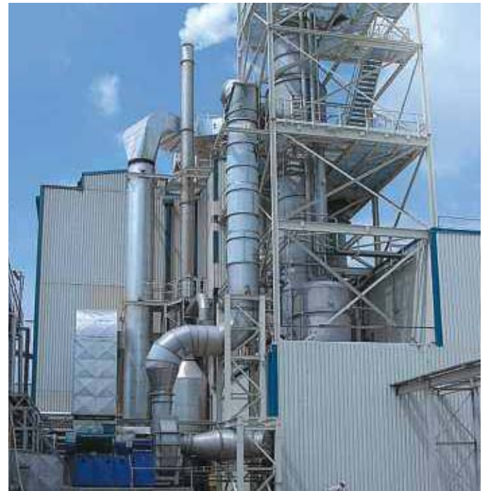
Planta de evaporación de película descendente de 1 efecto calentada por vahos comprimidos mecánicamente para efluentes de almidón de trigo. Caudal de evaporación: 17.000 kg/h
