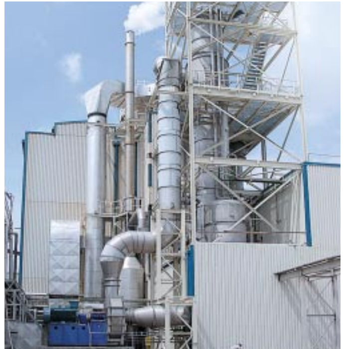
1-stufige Fallstrom-Eindampfanlage mit mechanischer Brüdenverdichtung für Weizenstärkeabwasser, Verdampfleistung: 17.000 kg/h
