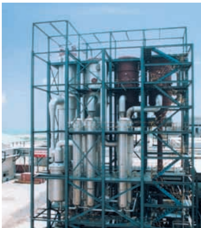
3效降膜强制循环蒸发装置，带热力蒸汽再压缩机，用于味精废水处理。 蒸发量：50 t/hr。
