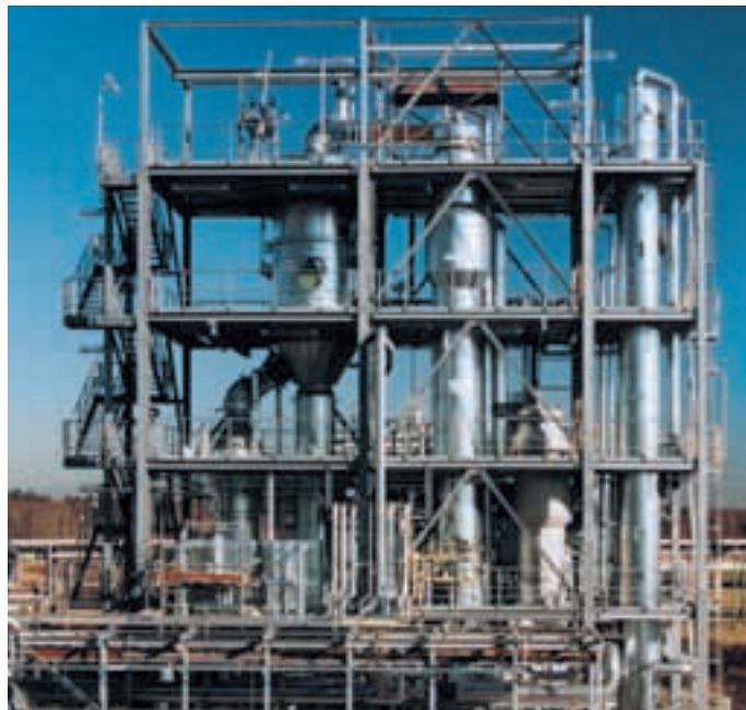
2效降膜强制循环蒸发装置
